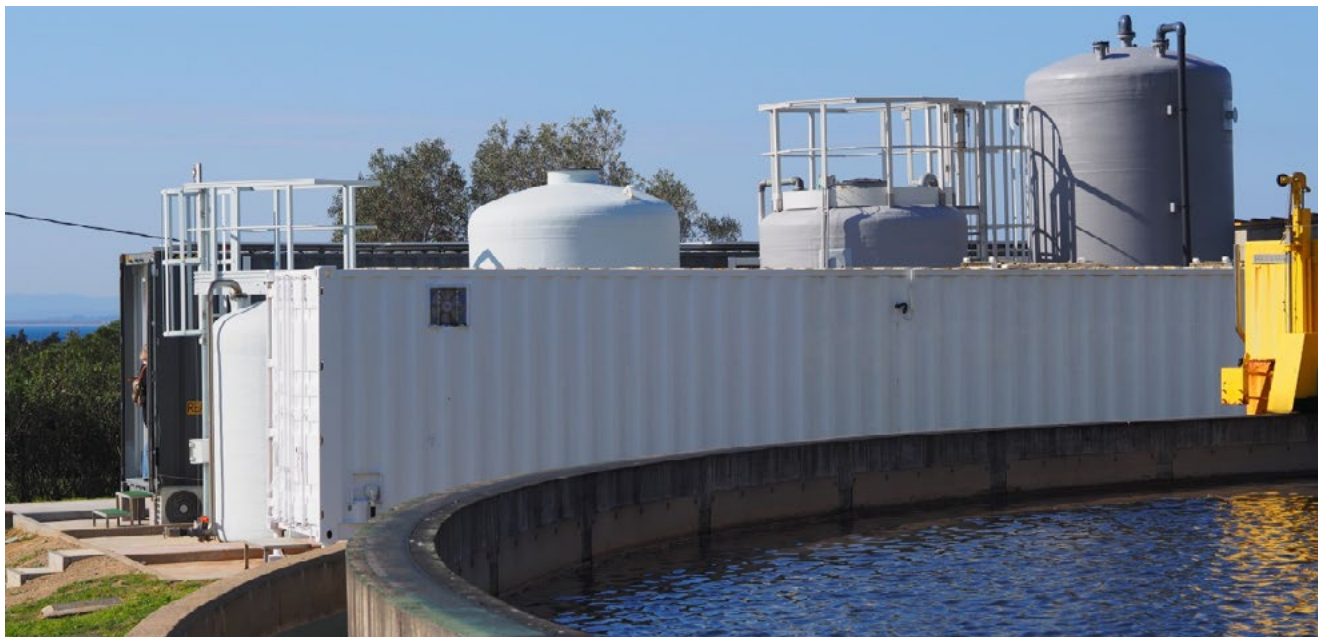
La planta pilot de l'estació depuradora d'aigües residuals de Roses, que usa sis tractaments diferents per assegurar que els paràmetres de l'aigua resultant compleixin la normativa existent i assegurin una aigua de molt bona qualitat.
